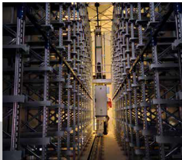
Uno dei 6 robot trasloelevatori
