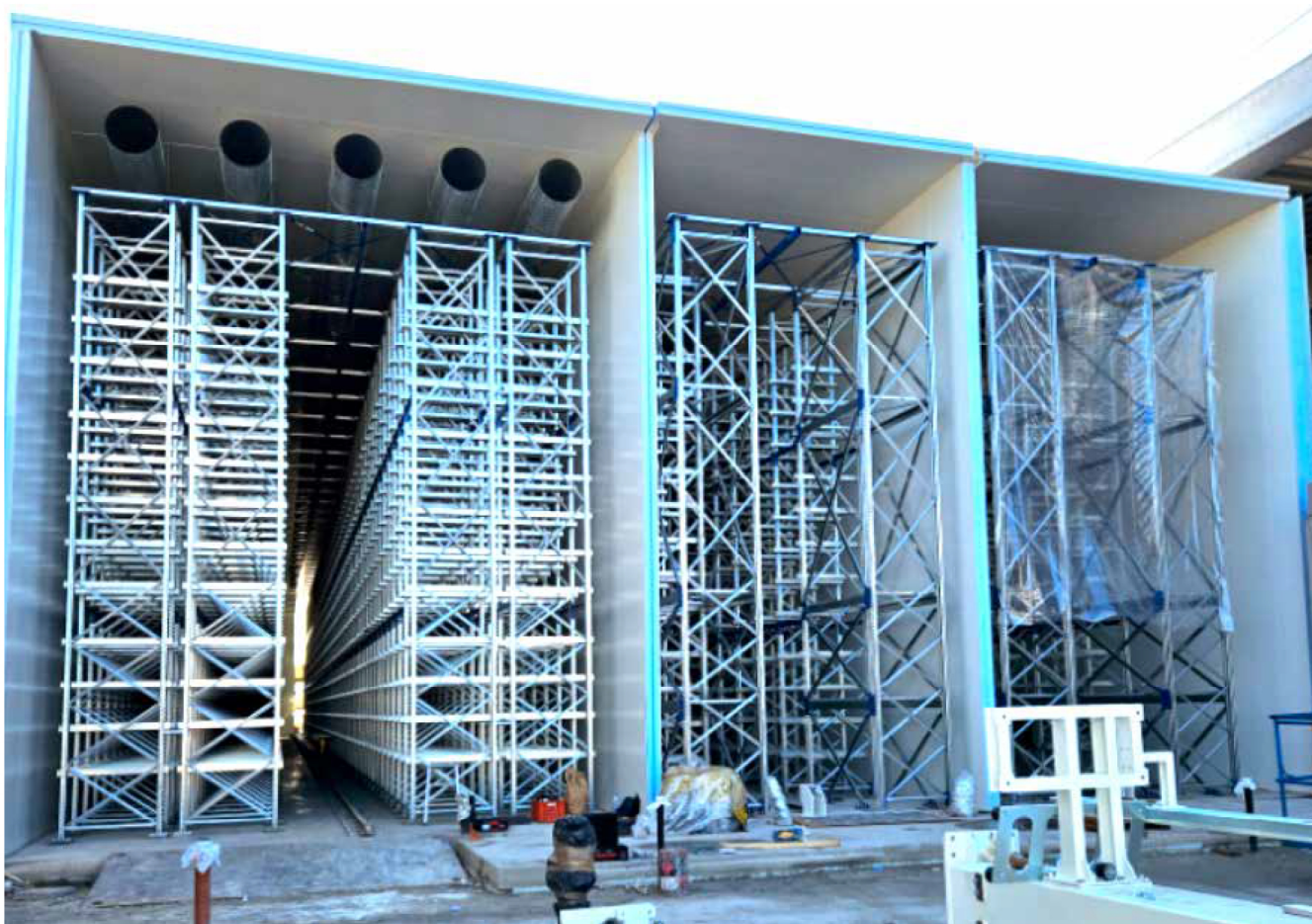
3 robot trasloelevatori in allestimento nelle loro celle di lavoro
